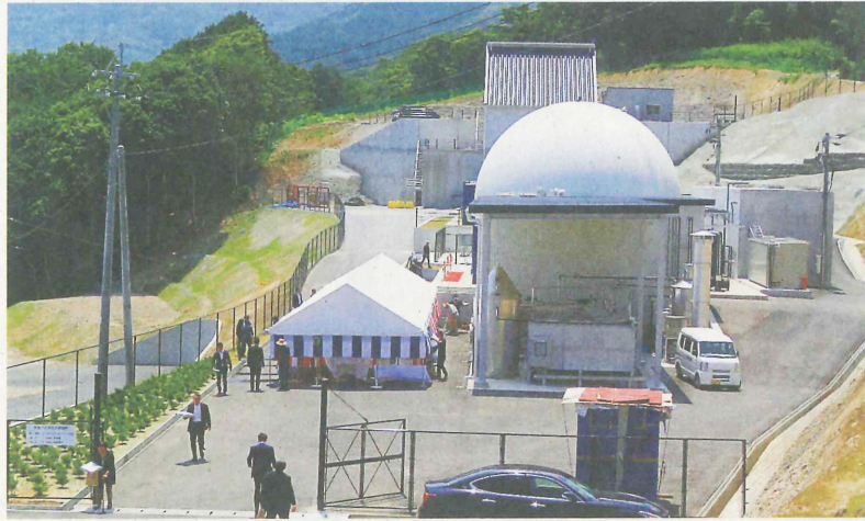
宇佐市に完成したバイオガス発電所
